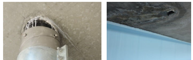
図 2.3 隙間や長さが足りず漏水している例
