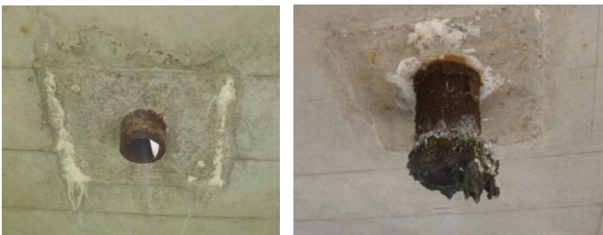
図 2.1 既設管腐食例
