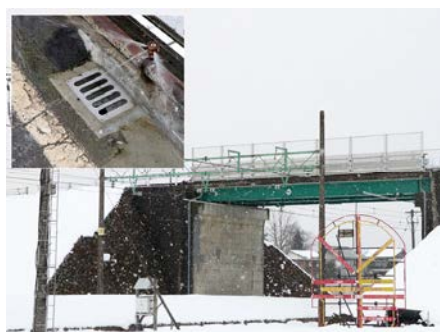
⑤積雪および降雪 -5 SUS目皿仕様の排水柵を使用しています。 消雪施設より散水しています。
