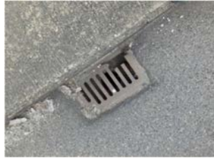
⑥ 蓋が損傷、破損している。
