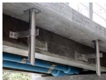
支持金具が1組有り
