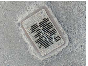
⑥ 排水枡の土砂、ごみの詰まり。
