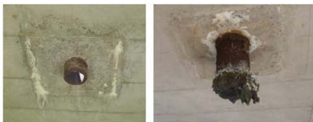
図 2.1 既設管腐食例
