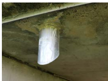
排水桝とコンクリート間より漏水している例
