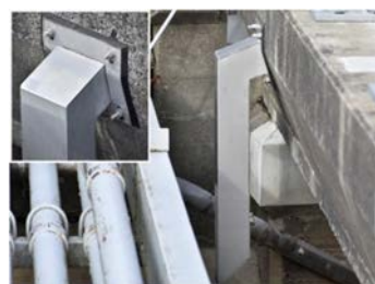
角管で天板部に曲げがある例
