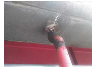
② 桁とコンクリートの隙間から遊離石灰や浸水、滞水が発生している。
