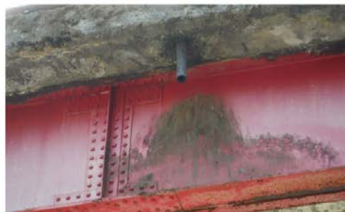
図 2.2 飛沫水による桁への影響例
