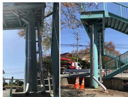
③設置例（歩道橋）
