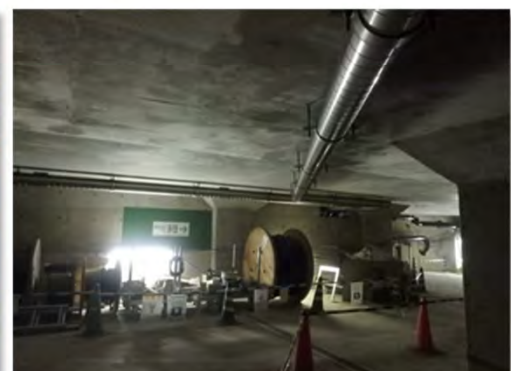
㉔トンネル換気施設内 万一の火災時に備え、難燃材料ということで採用頂きました
