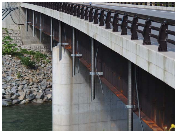
・新設橋 鋼橋 φ200を使用しています
