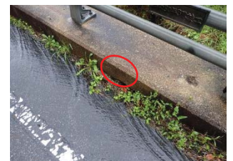
地覆貫通管が詰まり水が流れていない例
