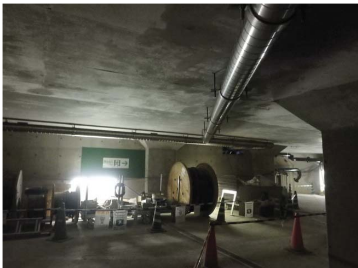
・トンネル換気施設内 万一の火災時に備え、難燃材料ということで使用頂きました
